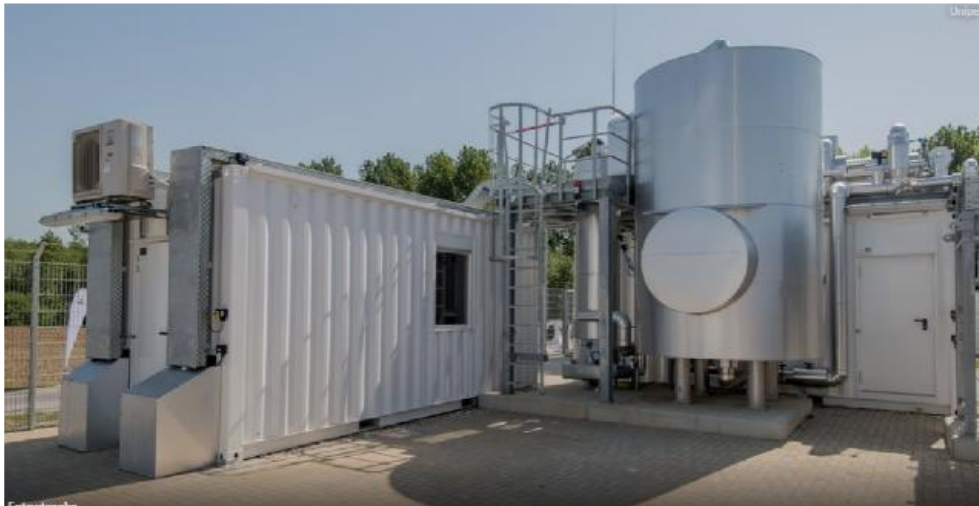
Bild 3: Kleine Anlage zur Wasserstoffgewinnung (Uniper) zur Veranschaulichung
